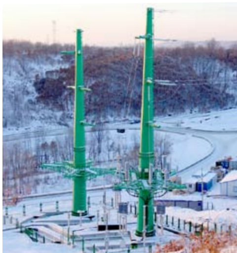
Двухцепная ВЛ 220 кВ Нижне-Бурейская ГЭС — Архара в Амурской области
